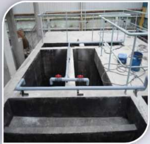
Hệ thống xử lý nước thải chăn nuôi
