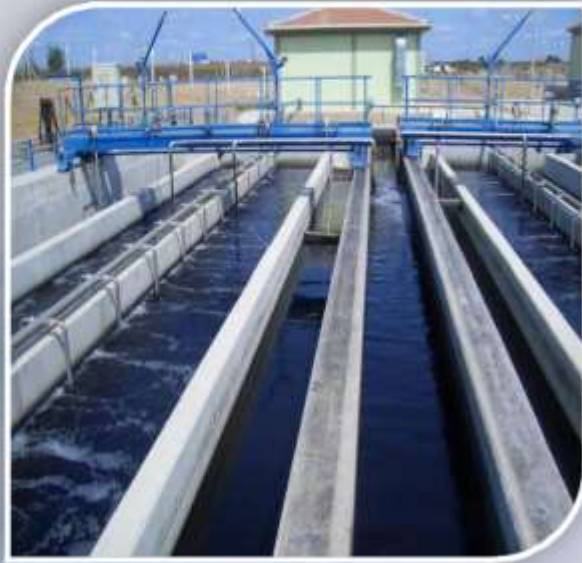
Hệ thống xử lý nước thải dệt nhuộm
