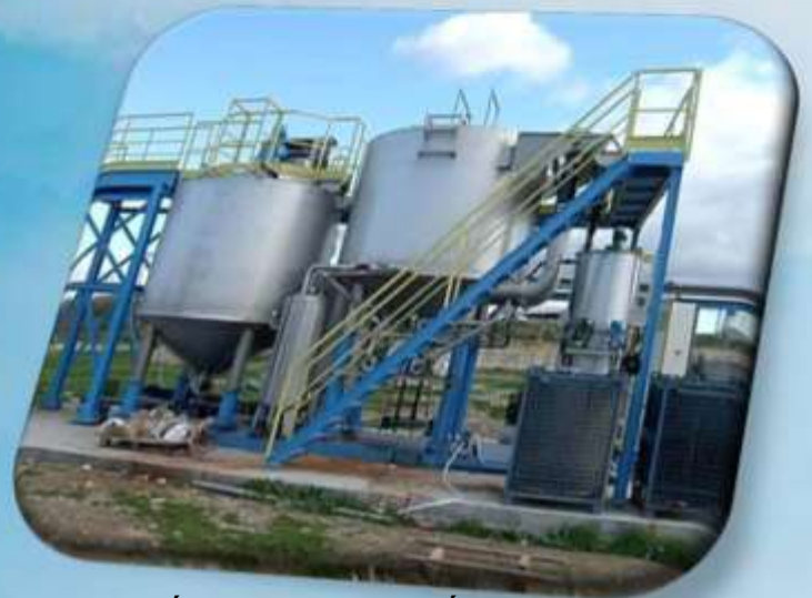
Hệ thống xử lý nước cấp từ nước mặt
